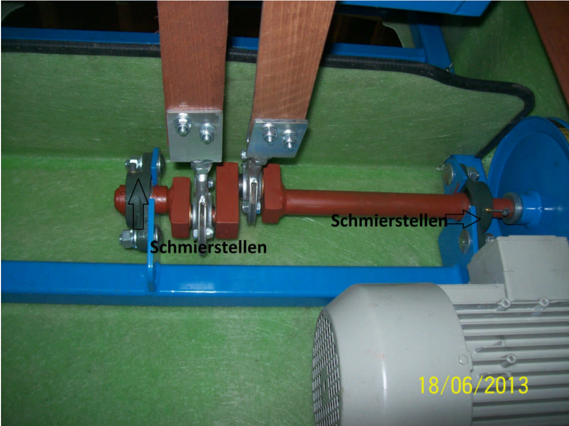
Bild von den Schmierstellen an der Maschine
